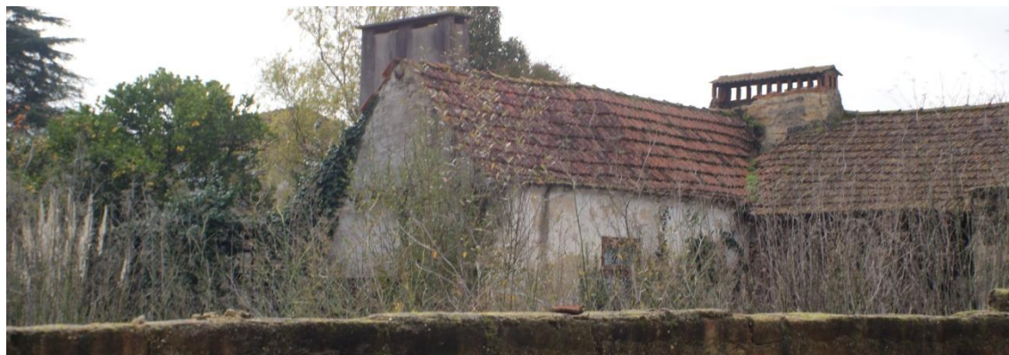
Figura 38 – Edifício em mau estado de conservação
