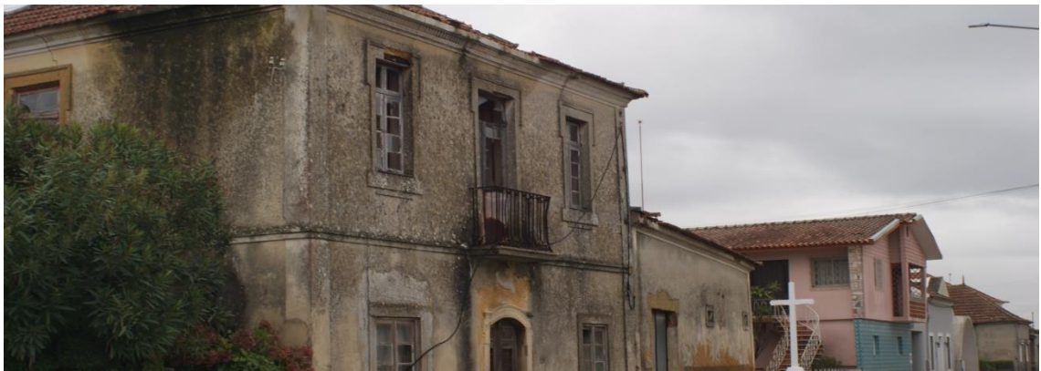
Figura 33 – Edifício em mau estado de conservação
