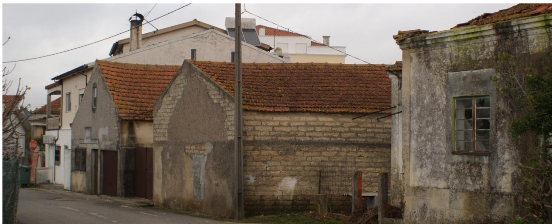
Figura 34 – Edifício em mau estado de conservação
