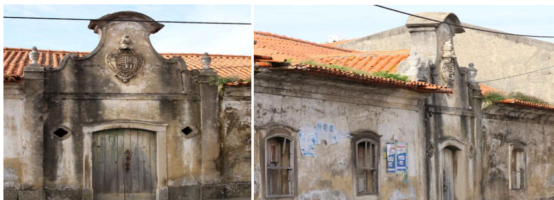
Figura 41 – Edifício do 'Solar dos Salgados', em mau estado de conservação
