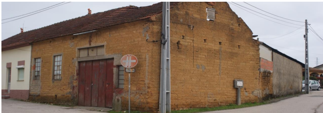
Figura 21 – Edifício em mau estado de conservação no centro urbano de Oiã
