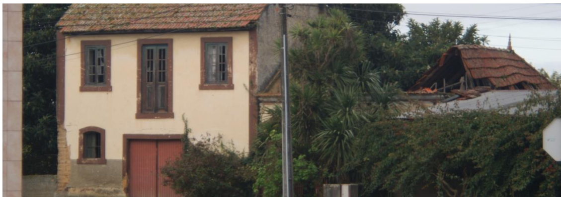
Figura 36 – Edifício em mau estado de conservação
