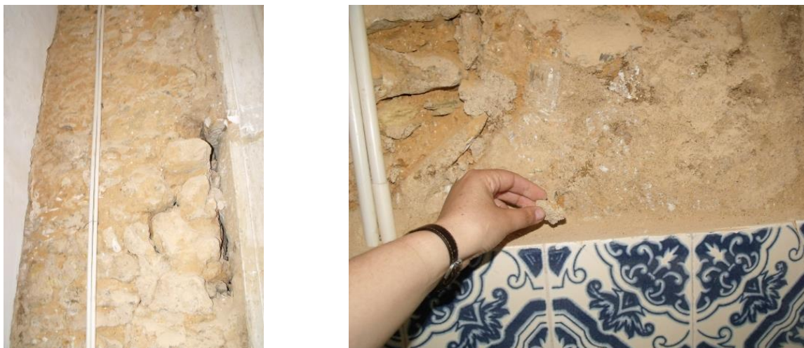
Imagens 19 e 20 – Imagens de pedra/desagregação de elementos da alvenaria
