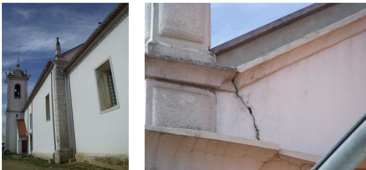
Imagens 21 e 22 – Imagens fissura na parede de ligação Nave/Capela-mor (arco cruzeiro pelo exterior)
